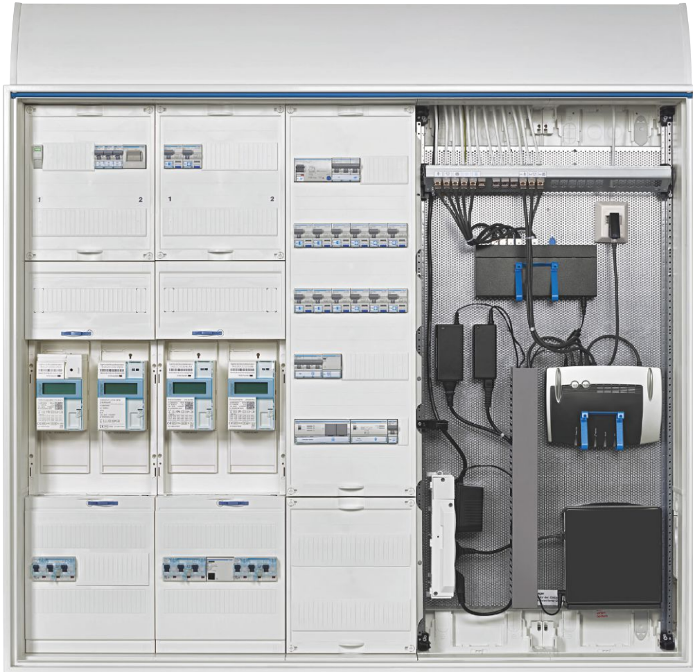
Technikzentrale mit Multimediafeld
