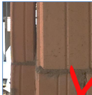
Falsch ohne Mörtelfuge
