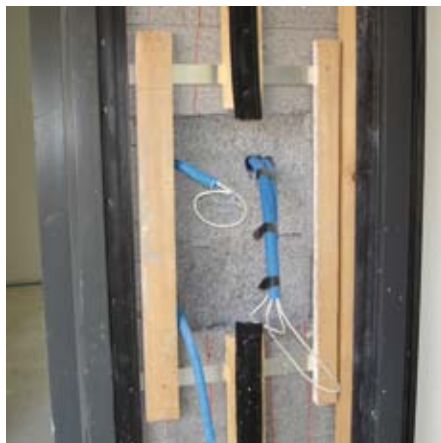
Detail mit Elektrorohren
